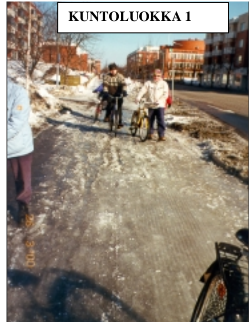
Kuva 8. Erittäin huonossa kunnossa oleva pyörätie
