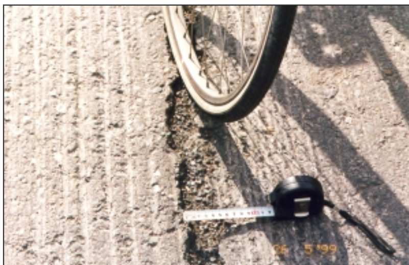
Kuva 2. Tätä kesän alussa 1. kunnossapitoluokan kevyen liikenteen väylältä havaittua vaurioita (leveys noin 10 cm) ei paikattu koko kesänä (Oulu).
