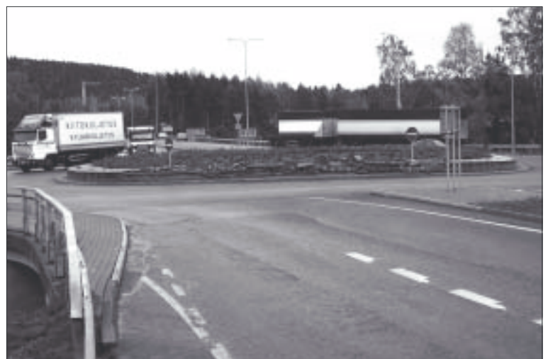
Kuva 19. Tukimuuri säiliöauton "halauksen" jälkeen.
