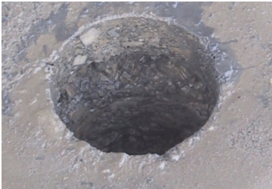
Kuva 23. Näytterikä paalulta 19170 suunnalta Kemi – Tornio. Vaurioitunut kerros varisi välittömästi näytteenottoreiän pohjalle.
