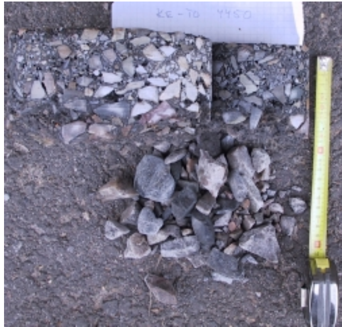
Kuva 24. Halkaisijaltaan 100 ja 200 mm:n poranäytteet paalulta 4450 m suunnasta Kemi – Tornio. ABK:n alapuolella oleva BST oli käytännössä murentunut. Huomattavaa on että porareistä kaivetut kivet olivat lähes puhtaita eikä bitumia tavattu edes pienempien kivien pinnalta. Sidotun kerroksen pp-laitetuloksista takaisinlaskettu moduularvo oli tällä kohdalla vain 1165 Mpa.
