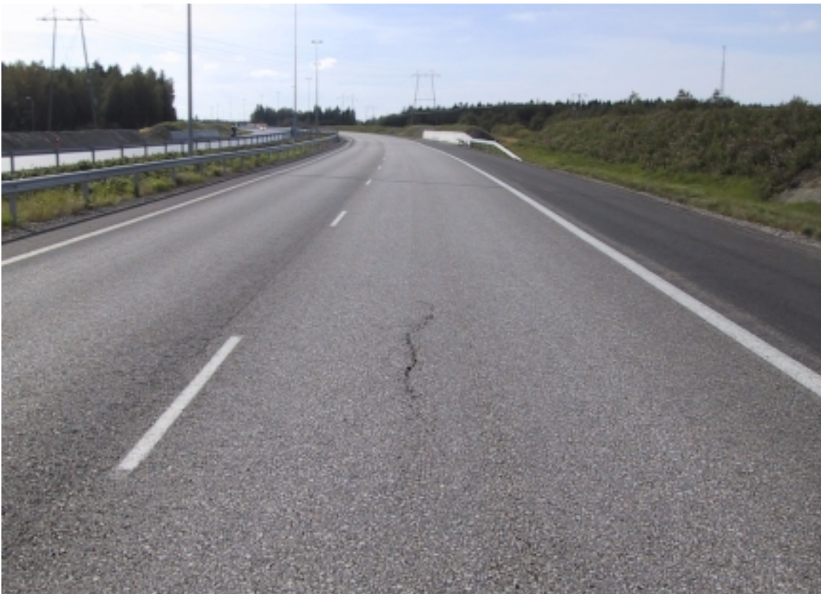
Kuva 18. Esimerkki pituushalkeamasta Tornio – Kemi suunnan paalulta n. 4000 m. Pituushalkeaman kohdalla havaittiin talvella myös kapeaa saumahalkeamaa.
