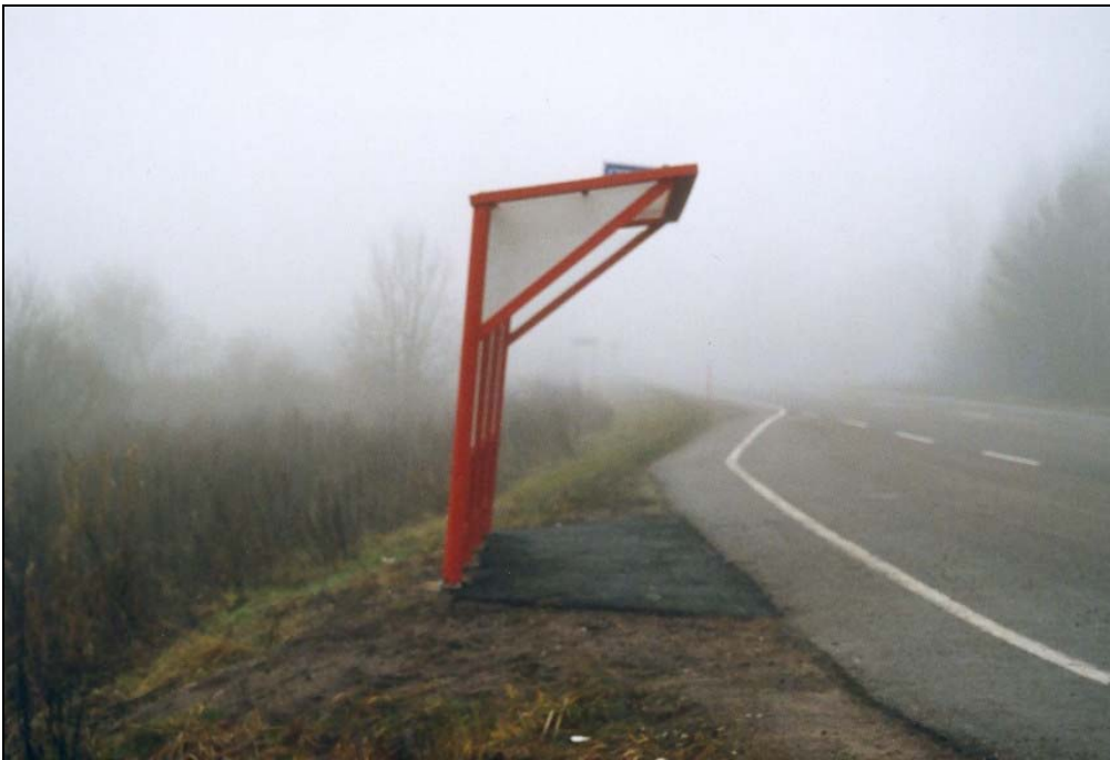
Kuva 12 Ammattiopiston Lopen suunnan pysäkkikatos rikkoontuneena.
