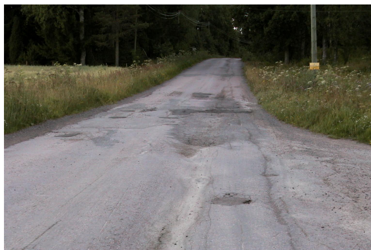
Kuva 2.4. Esimerkki pahoin vaurioituneesta tiestä (pt 13081, Hämeenkyrö, KVL 345 ).
