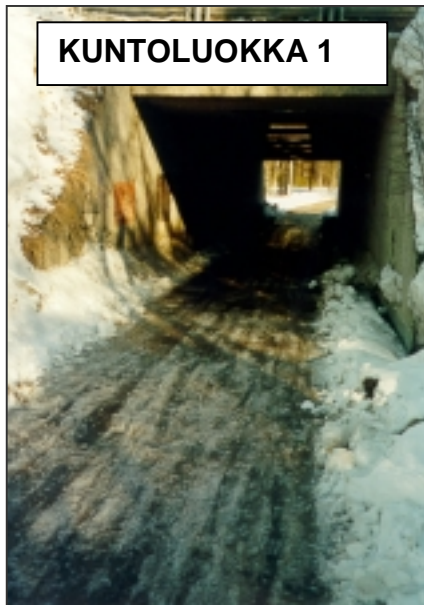
Kuva 42. Kapeat alikulut ovat vaikeita hoidettavia ja vaarallisia paikkoja kevyen liikenteen väylien käyttäjille erityisesti keväisin (kohde 4).
