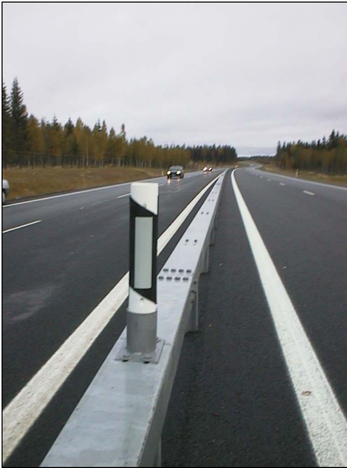
Kuva 6-4. Keskikaiteeseen kiinnitetty reunapaalu valtatiellä 5 Kuopion eteläpuolella. Lopella on käytössä pyörästetty kaideprofiili, johon sopiva kiinnitystapa on kehitetty valtatie 9 Orivesi - Muurame -hankkeella. Vaihtoehtona voidaan kokeilla kaidetolppiin kiinnitettäviä heijastinlevyjä, jotka ovat paremmin autojen valokiilan kentässä.
