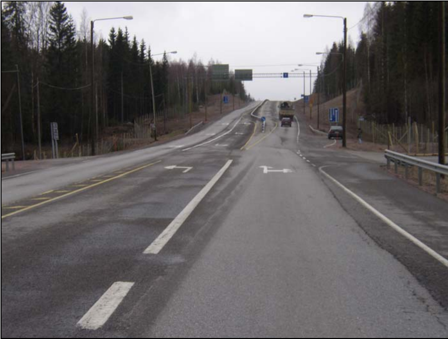
Kuva 6-1. Keskikaiteen alkupäässä (itäpää) peruskaistalla on pieni siirto oikeaan. Peruskaistan jatkeella oleva liikenteenjakaajamerkki kaiteen alkupäässä on ajettu nurin useita kertoja.
