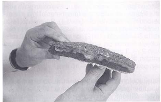
Kuva 9. Ruiskubetoni on karbonatisoitunut 10 vuodessa lähes kokonaan.
