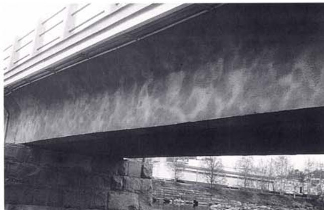
Kuva 18. Ruiskubetonipinnan värisävy vaihtelee häiritsevästi.
