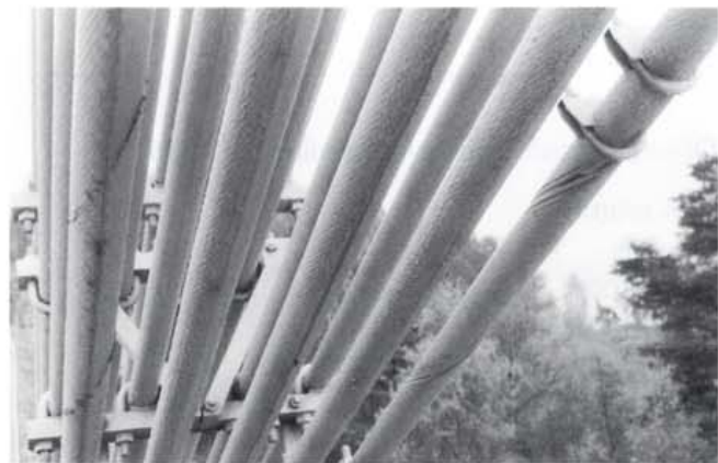
Kuva 8. Riippuköyden säikeitä on katkennut.
