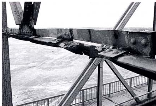
Kuva 10. Törmäysvaurio porttaalin poikkisiteessä.
