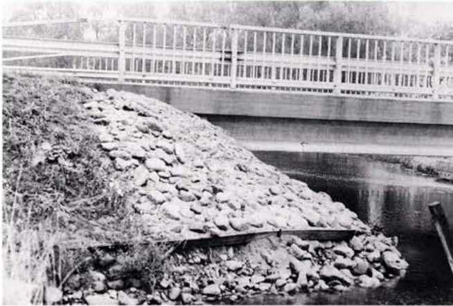
Kuva 26. Perustusten pettämisen vuoksi vaurioitunut keila
