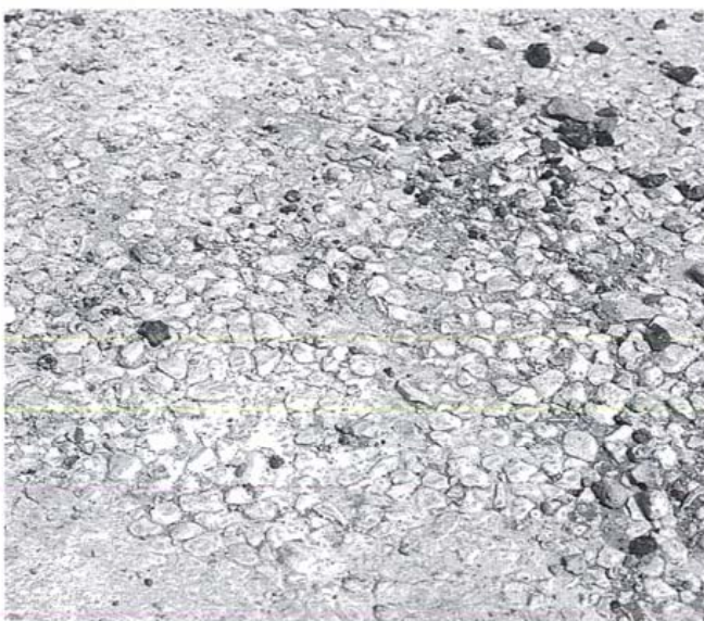
Kuva 2. Juotoslaastilla korjattava valuvika kansilaatassa.
