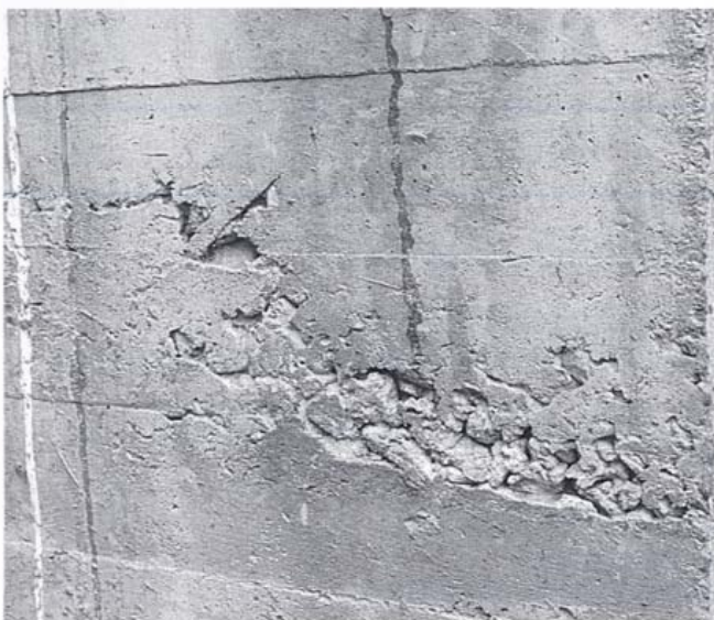
Kuva 1. Valumattomalla paikkauslaastilla korjattava valuvika.
