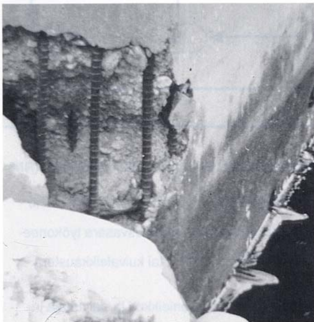
Kuva 1. Laajoja rapautumia on yleensä alusrakenteissa.
