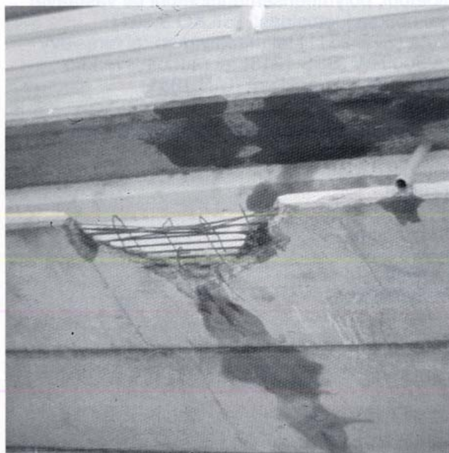
Kuva 2. Törmäysvaurio on korjattava ensi tilassa.
