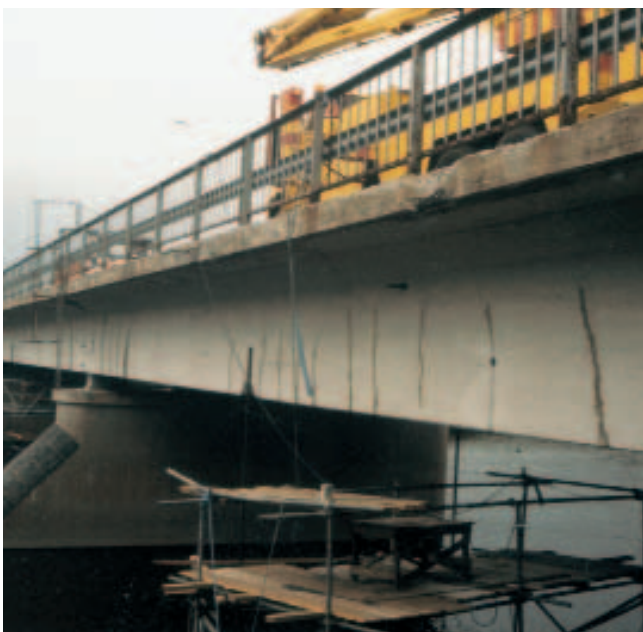
Kuva 1. Vioja leikkaushalkeamia tukien lähellä ja pystysuoria taivutushalkeamia aukon keskellä.
