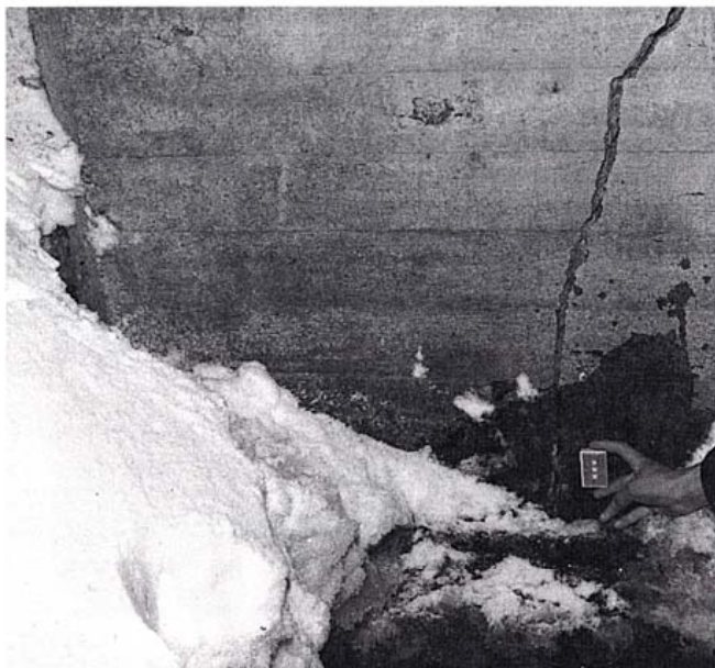
Kuva 1. Liian suuren maanpaineen aiheuttamia halkeamia.
