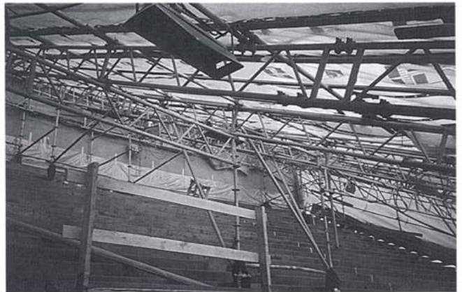
Kuva 15. Lämpösäteilijät sääsuojaan kiinnitettynä.
