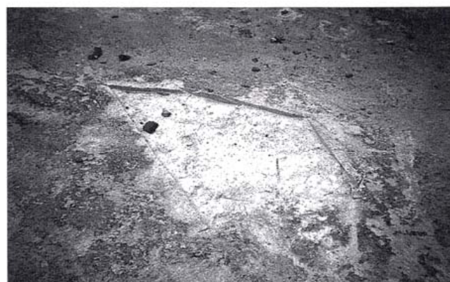
Kuva 6. Rapautunut kohta on rajattu siististi ja piikattu.
