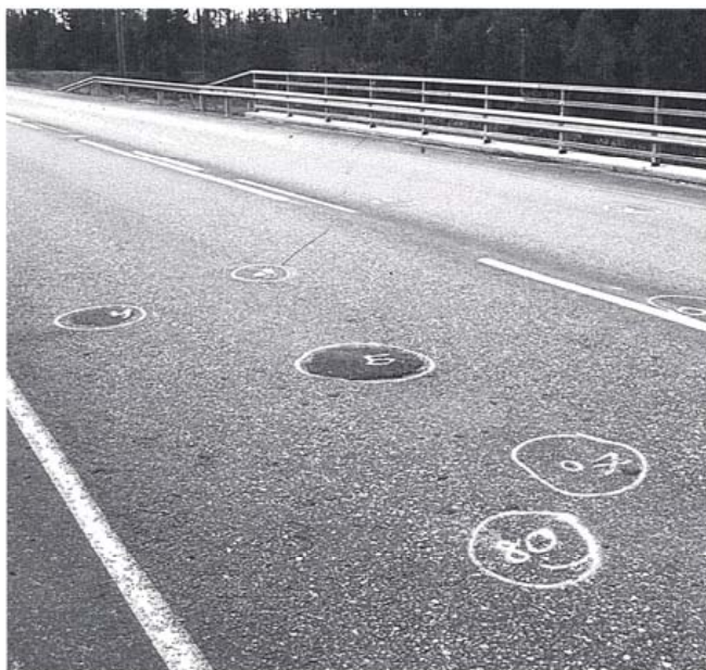
Kuva 1. Höyrystyneen kosteuden aiheuttamia kuplia päällysteessä.
