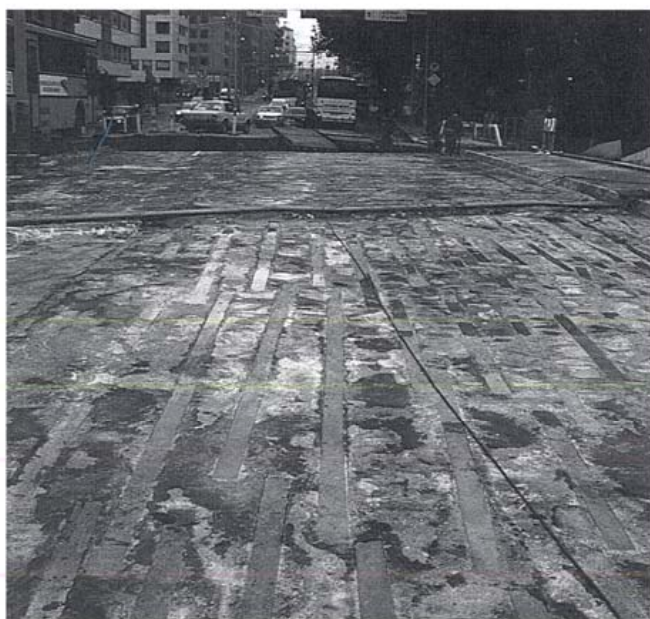
Kuva 2. Lankkujen aiheuttamia painanteita eristysalustassa.
