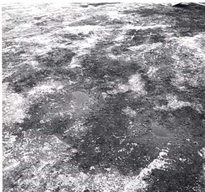
Kuva 1. Öljyä vedeneristysten alustassa.
