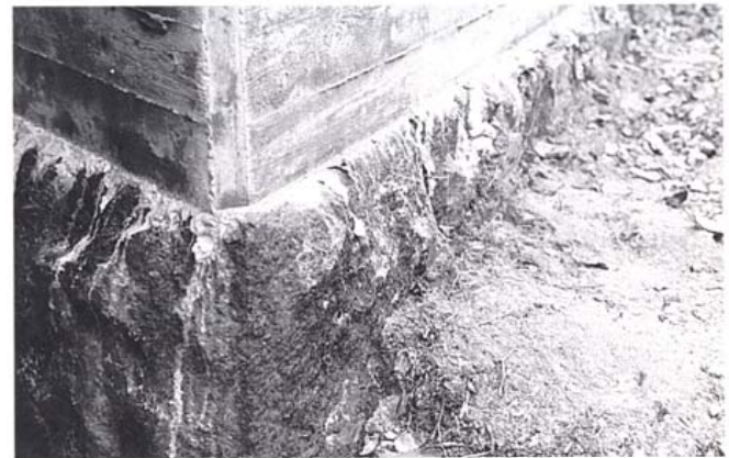
Kuva 9. Sementtiliimaa on valunut kivipinnoille.
