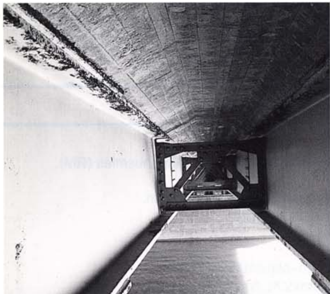
Kuva 1. Ylälaipan huonosta suojauksesta johtuva maalipinnoitteen vaurio.
