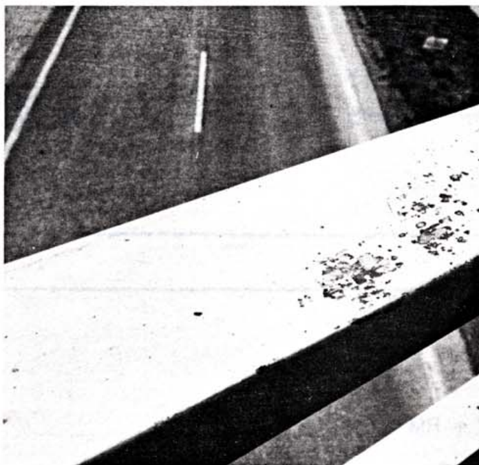
Liian ohut maalikalvo vaurioituu nopeasti.
