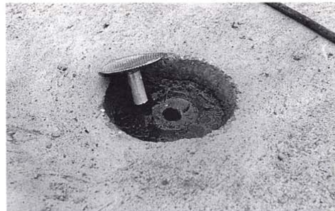
Kuva 16. Teräsuppilolla varustettu tippuputki ja aukko suojabetonissa.
