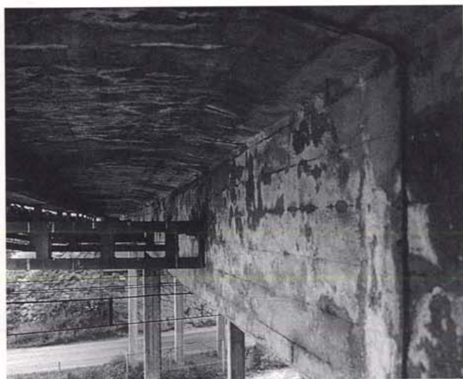
Kuva 2. Kalkkihärmää reuna- lokkeessa ja kansilaatan sivupinnassa.
