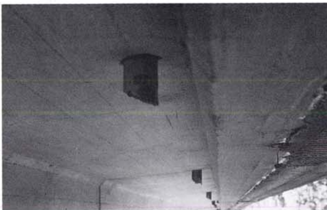
Kuva 3. Tippuputket kansilaatan alapinnassa.
