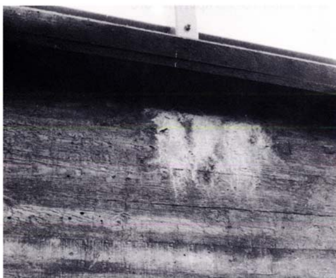
Kuva 2. Tippureikä on tarpeen tällaisessa tapauksessa
