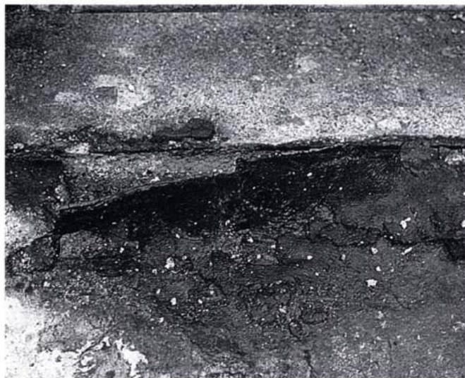
Kuva 1. Vedeneristys on vaurioitunut rakenteeseen patoutuneen veden vaikutuksesta
