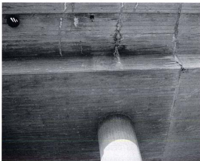
Kuva 2. Vesi suotautuu tippuputken molemmilla puolilla olevien halkeamien kautta.
