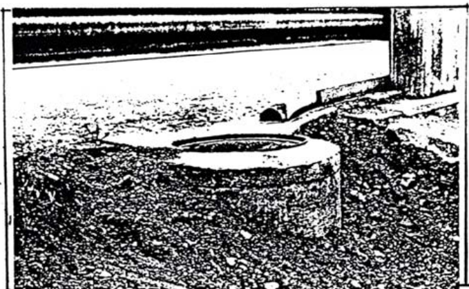
Kuva 17. Puutteelliset pintavesien ohjauslaitteet
