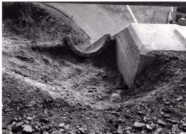
Kuva 15. Pintavesien ohjauslaitteet puuttuvat kourun yläpäästä.
