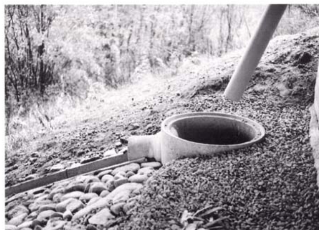
Kuva 8. Kaivonrenkaasta tehty loiskekuppi kourun yläpäässä.
