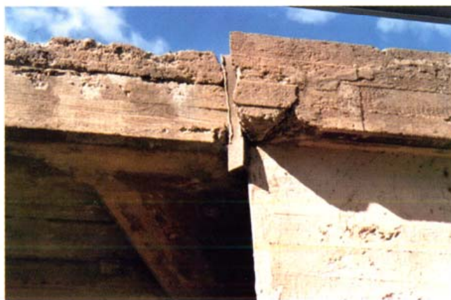
Kuva 2. Rapautuneet reunapalkit on korjattava ennen sauman tiivistämistä.
