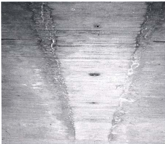
Kuva 1. Jos paineentasausputken ympärillä on kalkkihärmää tai kosteutta, mastiksieristys vuotaa.
