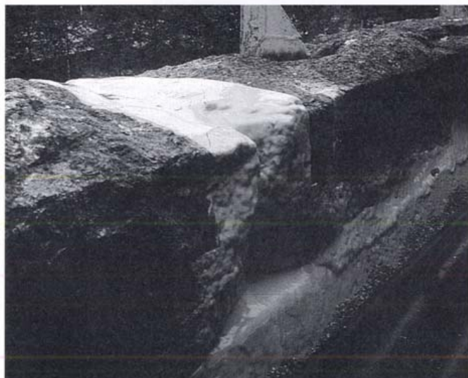
Kuva 3. Kivisen reunapalkin saumat ja liikuntasauvat on suljettu massaeristyksellä
