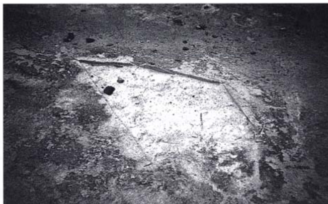
Kuva 6. Rapautunut kohta on rajattu siististi ja piikattu.
