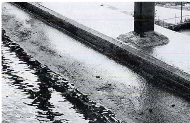
Kuva 13. Viiste päällysteen reunassa.
