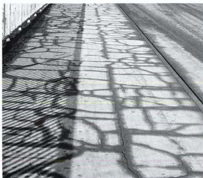
Kuva 2. Päällysteen pinta-alasta on yli kolmannes halkeillut.
