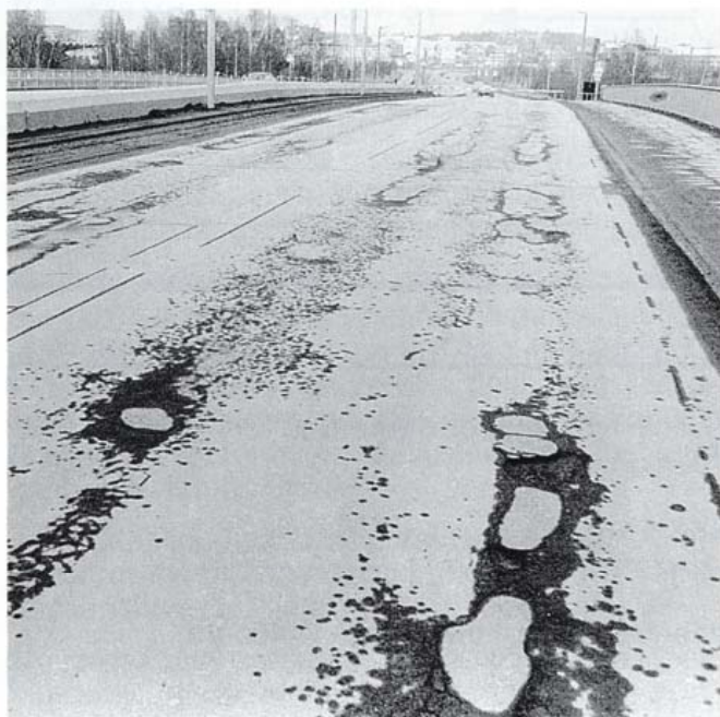
Kuva 1. Päällysteen pinta-alasta on yli kolmannes kulunut ja muuten vaurioitunut.
