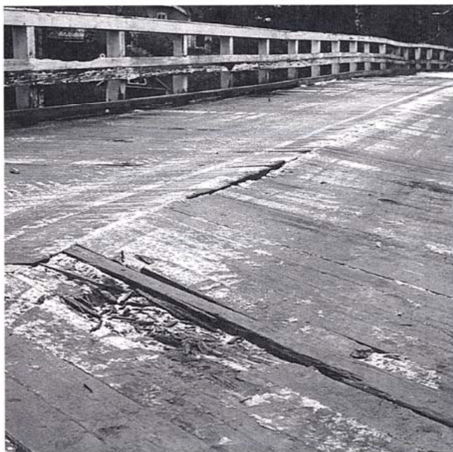
Kuva 1. Puukansi ei kestä mekaanista kulutusta.
