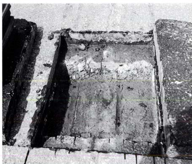
Kuva 2. Vedeneristys on korjattava aina pintarakenteita avattaessa.
