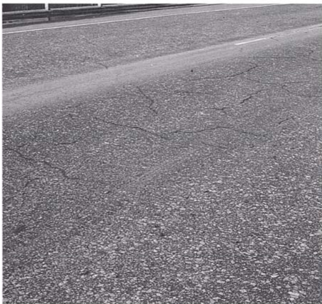
Kuva 1. Avonaiset halkeamat muodostavat suuren vaaran alapuolisille rakenteille.
