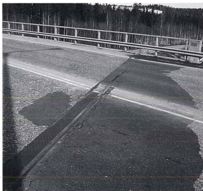
Kuva 2. Kynnys sillan ja penkereen rajassa aiheuttaa tarpeettomia iskuja siltarakenteille.
