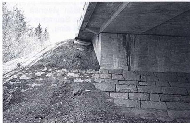
Kuva 20. Verhouksen päällä olevat maa-ainekset tukahduttavat saumojen kasvillisuuden ja rumentavat siltapaikkaa.
