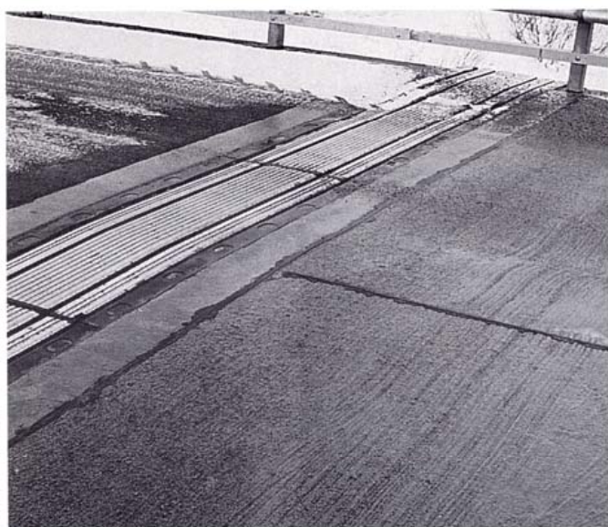
Kuva 4. Polymeeribitumista tehty saumat sillan betonisen ajotielaidan keskellä ja ajotielaidan ja liikuntasaumalaitteen tukikaistan rajakohdassa sekä tiepenkereen asfalttipäällysteen ja tukikaistan rajakohdassa.
