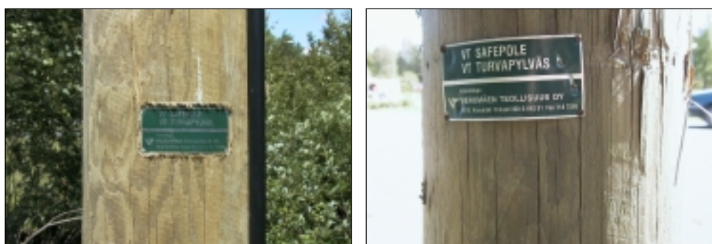
Kuva 33 ja 34. Safepool – myös ontoksi koverrettu – puupylväs. Oikean puoleisen kuvan mukaisesta vanhasta Safepool-pylväästä nimikilpi on usein irronnut pylvääseen kiipeämisen yhteydessä.
