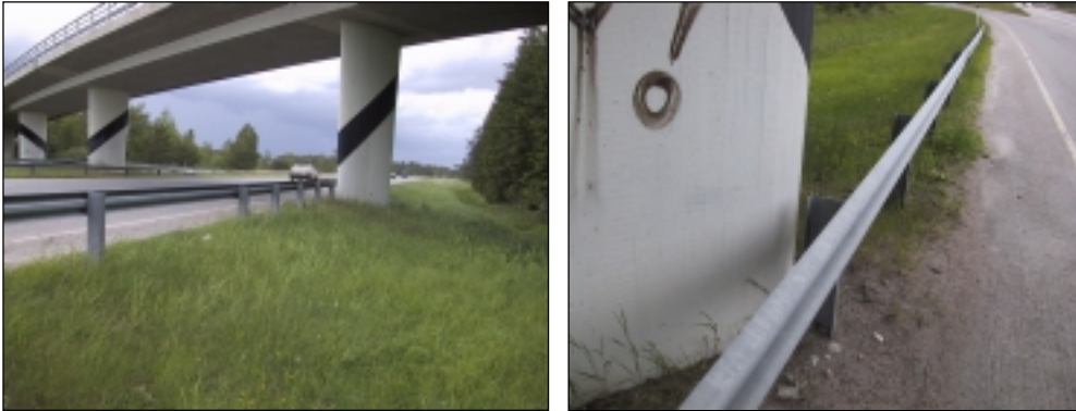
Kuva 25 ja 26. Etäisyys kaiteesta esteeseen tulee olla vähintään kaiteen toimintaleveys. Kuvan kaideratkaisu ei täytä vaadittua toimintaleveyttä, joka tällä kaidetyypillä pienen auton (900 kg x 100 km/h x 20°) aiheuttamassa törmäyksessä on 1,2 metriä.
