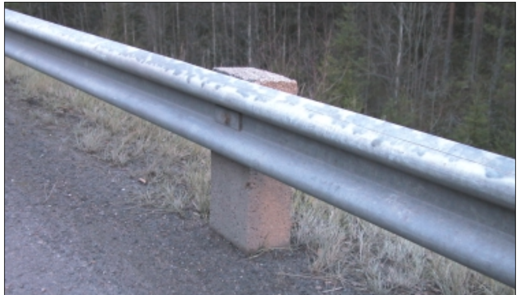
Kuva 1. Tiekaide, jossa betonipylväät ja kaiteen korkeus alle 0,55 m.
