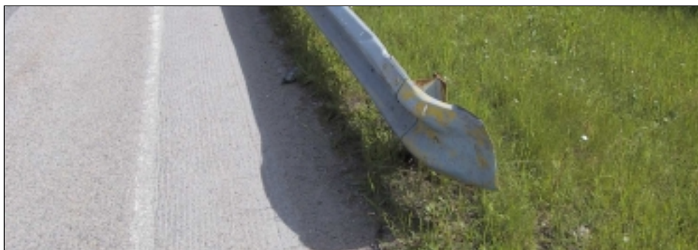
Kuva 6. Viiste puuttuu kokonaan kaiteesta. Tämän tyyppinen aloitusrakenne on erittäin vaarallinen, koska kaiteenpää-törmäyksessä on mahdollista, että johde lävistää auton matkustajatilan.
