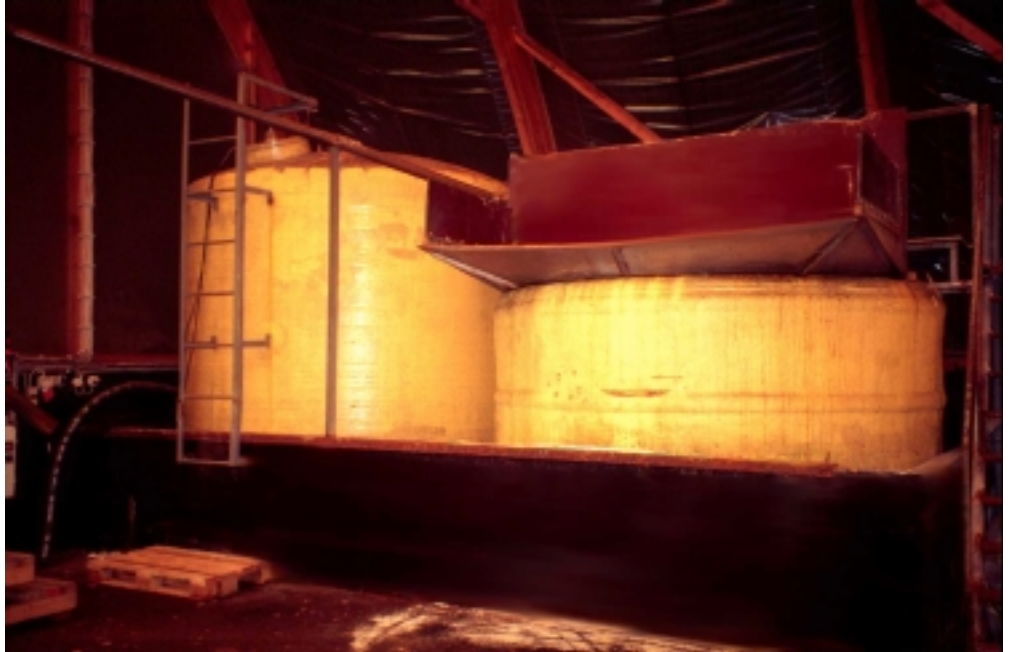
Kuva 24. Liuosasema sijoitettuna suolahallin sisälle.
