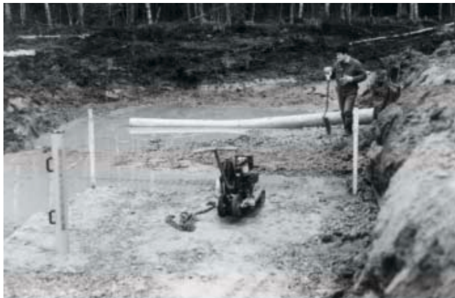
Kuva 5.7 Tilanne kohteella joulukuussa 1996. Kuvassa oikealla massastabiloinnin jyrkkä raja. Pumppaamisesta huolimatta vedenpinta kaivannossa alkoi nousta ja työt jouduttiin joulukuussa keskeyttämään.
