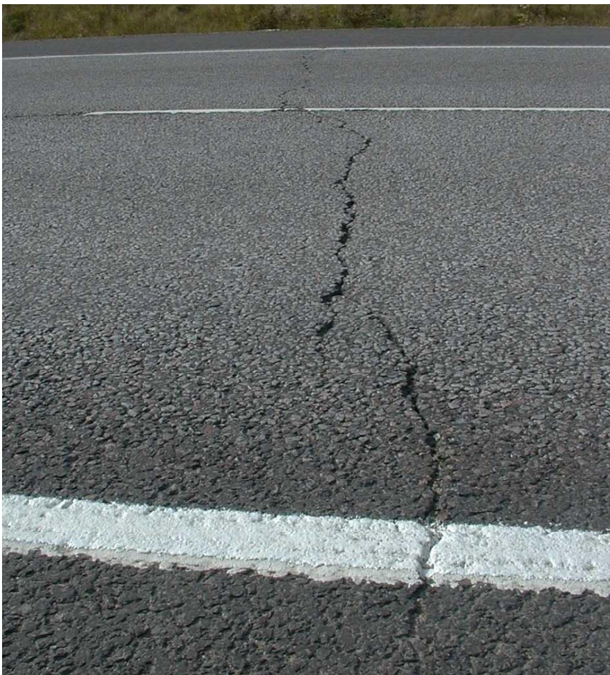
Kuva 16. Tyypillinen poikittaishalkeama koealueelta .
