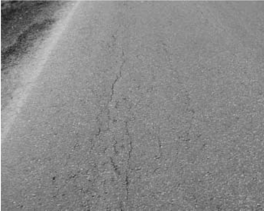
Kuva 33. Palaturveosuudella tien vasempaan ulkouraan muodostunutta verkkohalkeilun alkua Plv. 823 - 830.
