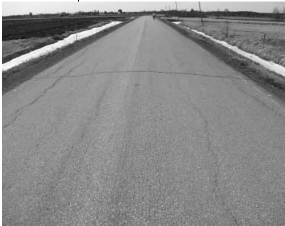
Kuva 35. Päällystevaurioita masuunihiekkarakenteessa paalulta Pl. 1050 eteenpäin.
