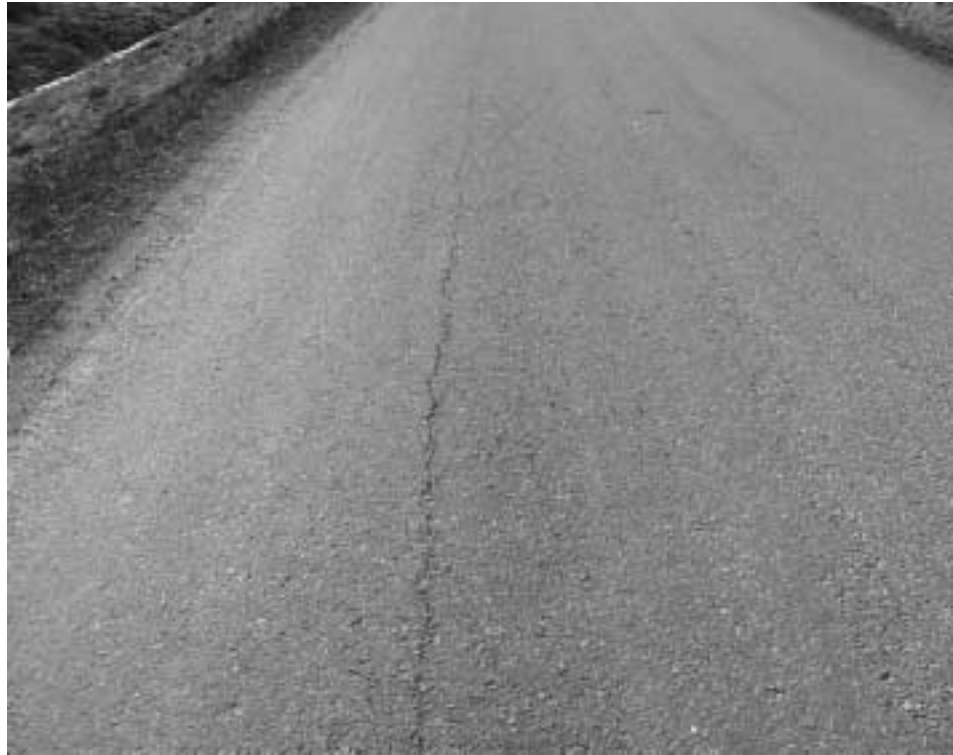
Kuva 34. Pituushalkeama palaturveosuudella Plv. 842 – 869 tien vasemalla ajoradalla 1,5 metrin etäisyydellä tien keskilinjasta.
