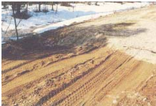
Kuva 53: Pahat routavauriot on korjattava mahdollisimman pian.
