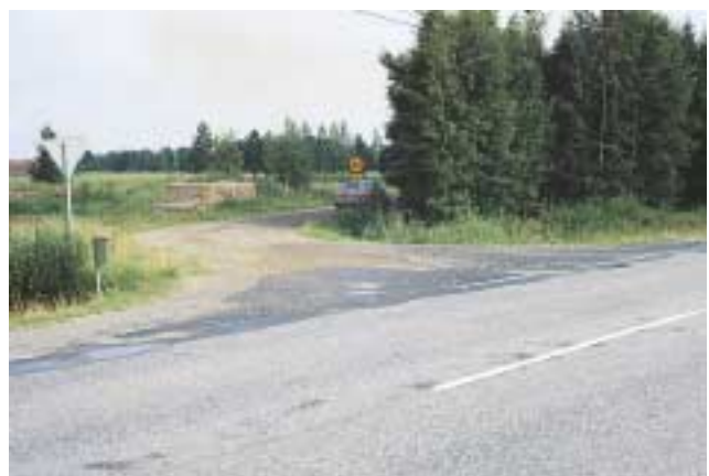
Kuva 40: Tiekunnan tulee poistaa irtokivet päällystetyltä liittymäalueelta.
