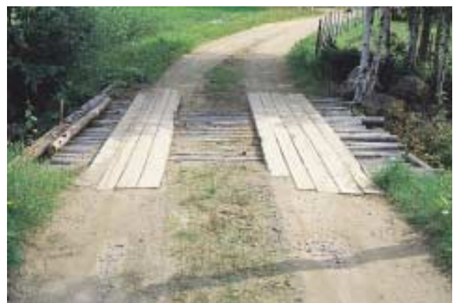
Kuva 55: Silta on kunnostuksen tarpeessa.
