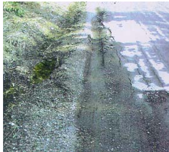
Kuva: Puutteellinen kuivatus heikentää kantavuutta.
